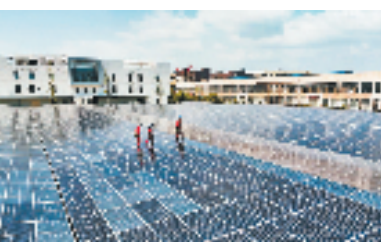
国网衢州供电公司员工对工业园区企业的厂区停车场屋顶光伏进行巡视检查。周炫炫 摄
