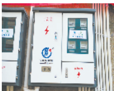
试点投运的智能集表箱外观（图片由国网嵊州市供电公司提供）
