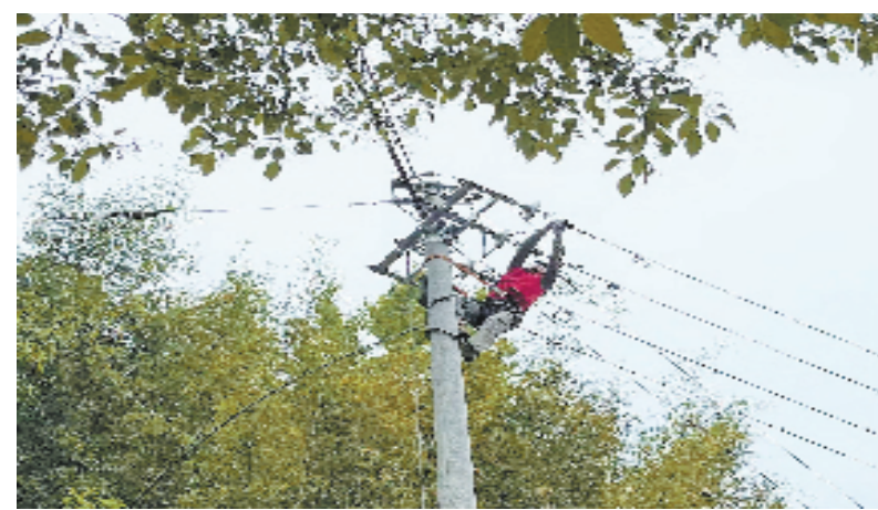
国网平阳县供电公司工作人员为水井抽水泵架设线路，解决村民用水难题。 方芳 摄
