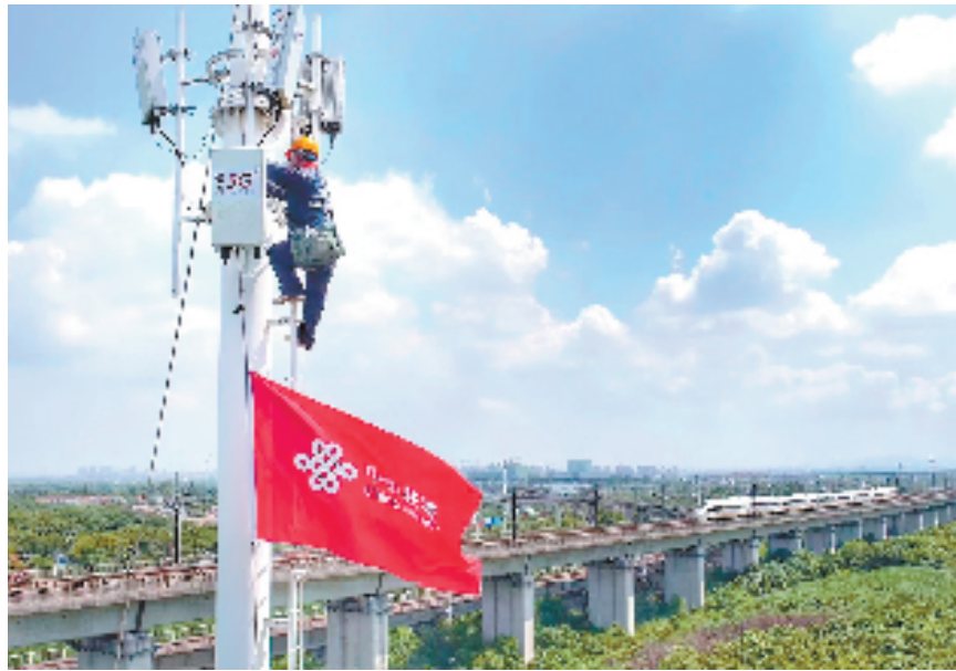
近日，浙江联通完成全国最大规模64T/32T商用覆盖的5G高铁专网工程，跑出5G网络“中国速度”。
