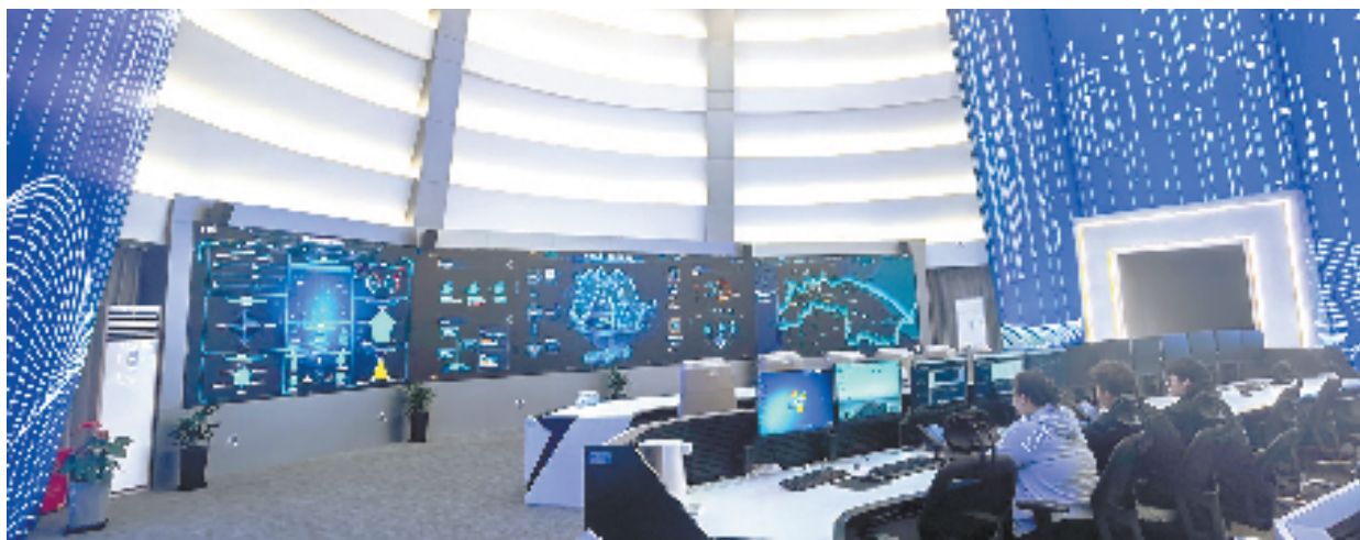
港电大脑·县域决策中心的调度大厅
