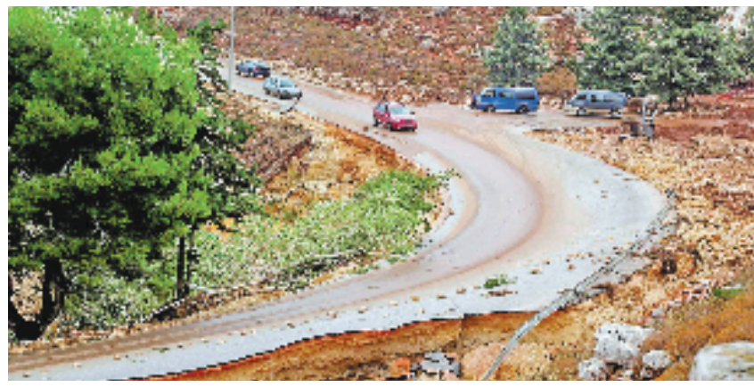
9月11日,在利比亚东部舍哈特,一段公路被洪水侵蚀出现塌方。 新华社发
