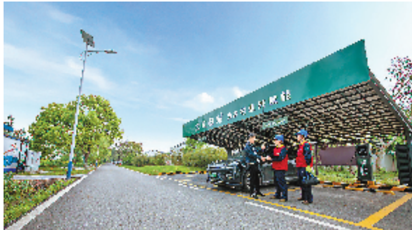
国网嘉善县供电公司员工在姚庄镇横港村光储充一体化充电e站开展巡检,为村民绿色出行保驾护航。 国网浙江电力供图
