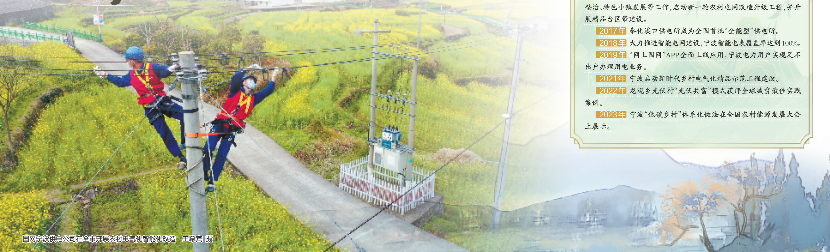
国网宁波供电公司工作人员,为奉化桃园基地架设电缆线路。 王幕宾 摄
