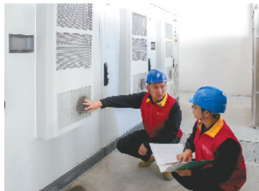
国网桐乡市供电公司工作人员为企业能效提升服务 沈佳伟 摄
