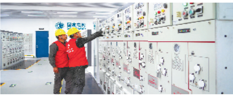
7月24日,在莫干山镇馒头村,国网德清县供电公司工作人员调试全感知馒头开关站,提升山区供电能力。 范力行 摄
