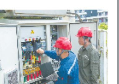
电力工作人员安装调试配网智能有载无级调压变压器。 陈海卯 摄
