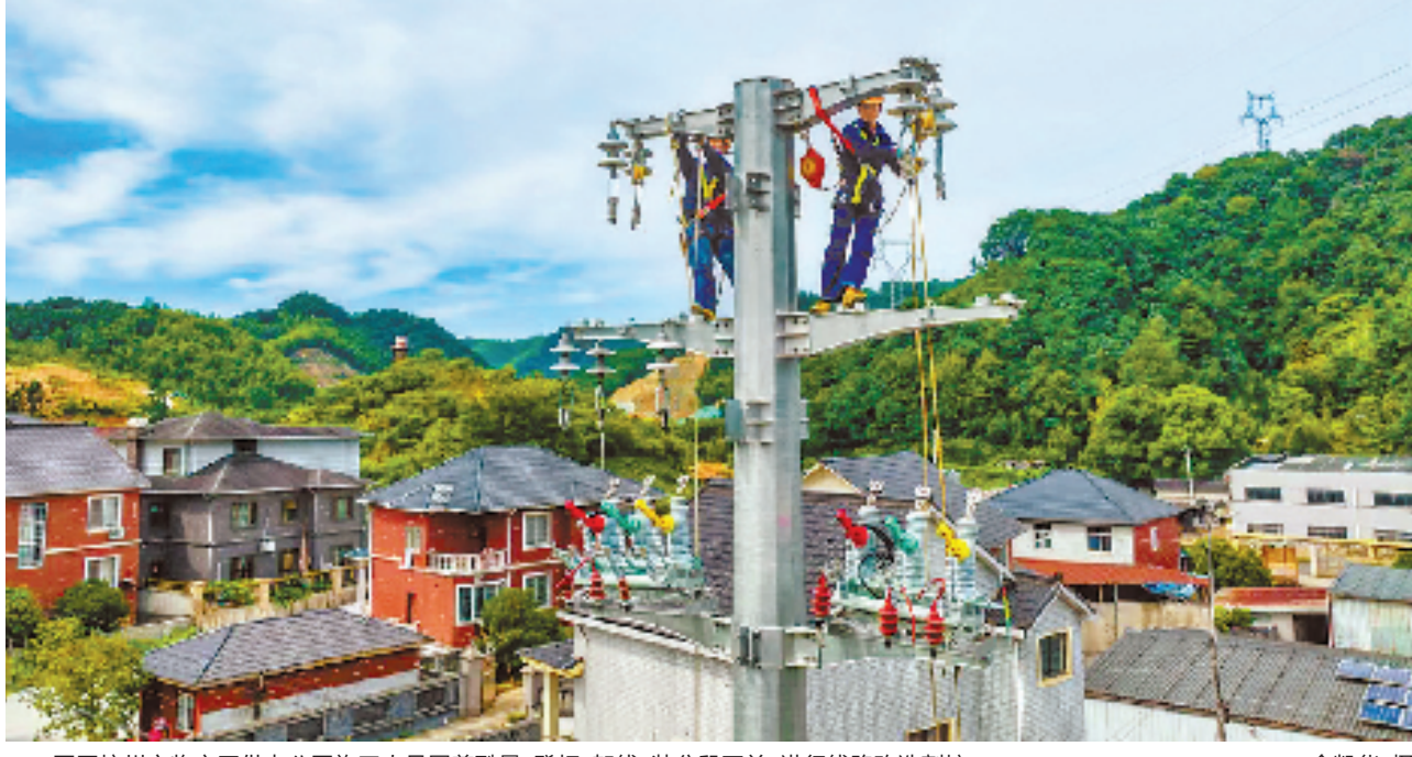
国网杭州市临安区供电公司施工人员冒着酷暑,登杆、架线、装分段开关,进行线路改造割接。 金凯华 摄
