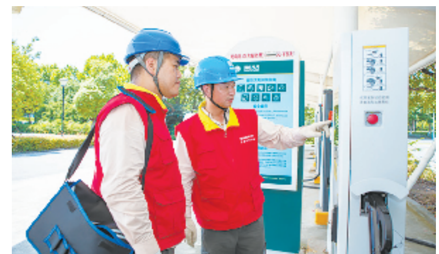
供电公司员工为公共充电桩“体检” (图片由国网浙江省电力有限公司湖州供电公司提供)
