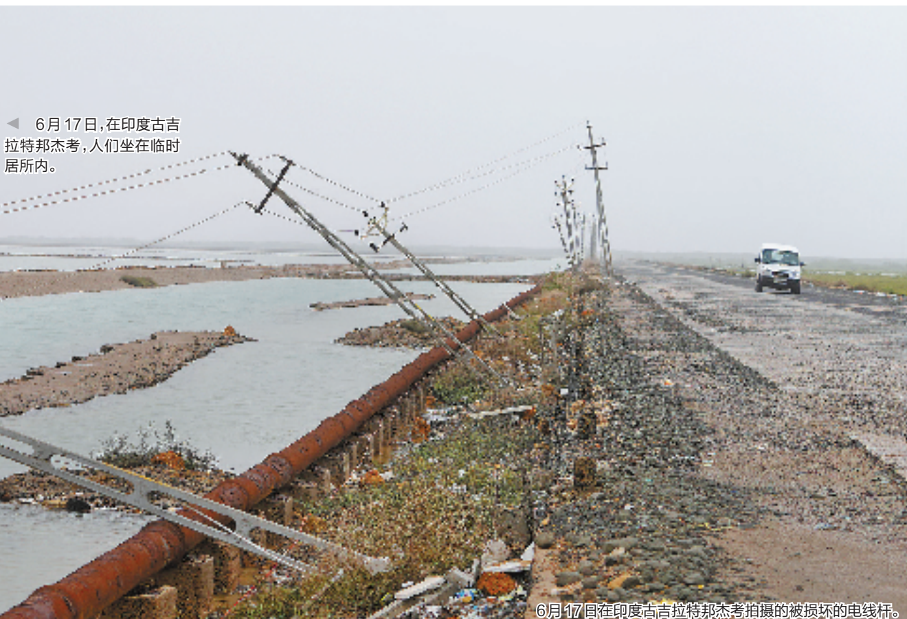
6月17日在印度古吉拉特邦杰考拍摄的被损坏的电线杆。
