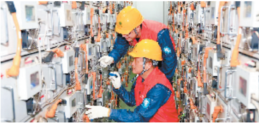
5月11日，国网绍兴市上虞区供电公司工作人员正在用“无感响应”管理平台对储能装置的手动和自动集控功能进行调试。（图片由国网绍兴市上虞区供电公司提供）
