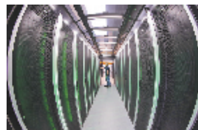
一舟集团微型数据中心
