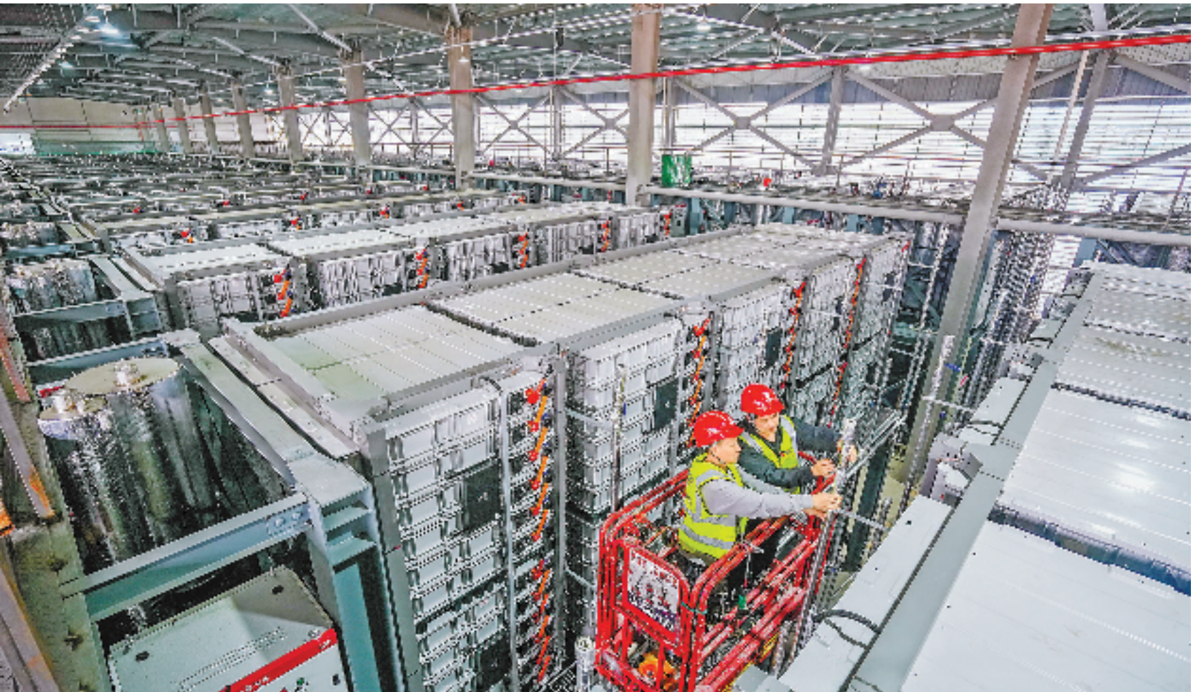
这几天,位于长兴县和平镇的湖州综合智慧零碳电厂“和平共储”项目上,运维人员正在对电池模组进行维护检查。该项目由国家电投投建,日前正式并网运行。据悉,这是目前国内最大的铅碳储能电站,年调峰电量超过3亿KWh。 共享联盟·长兴 吴拯 摄
