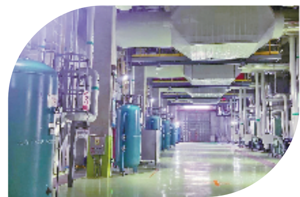
利用天然气发电的能源站内燃机组 本报见习记者 张琬琪 摄
