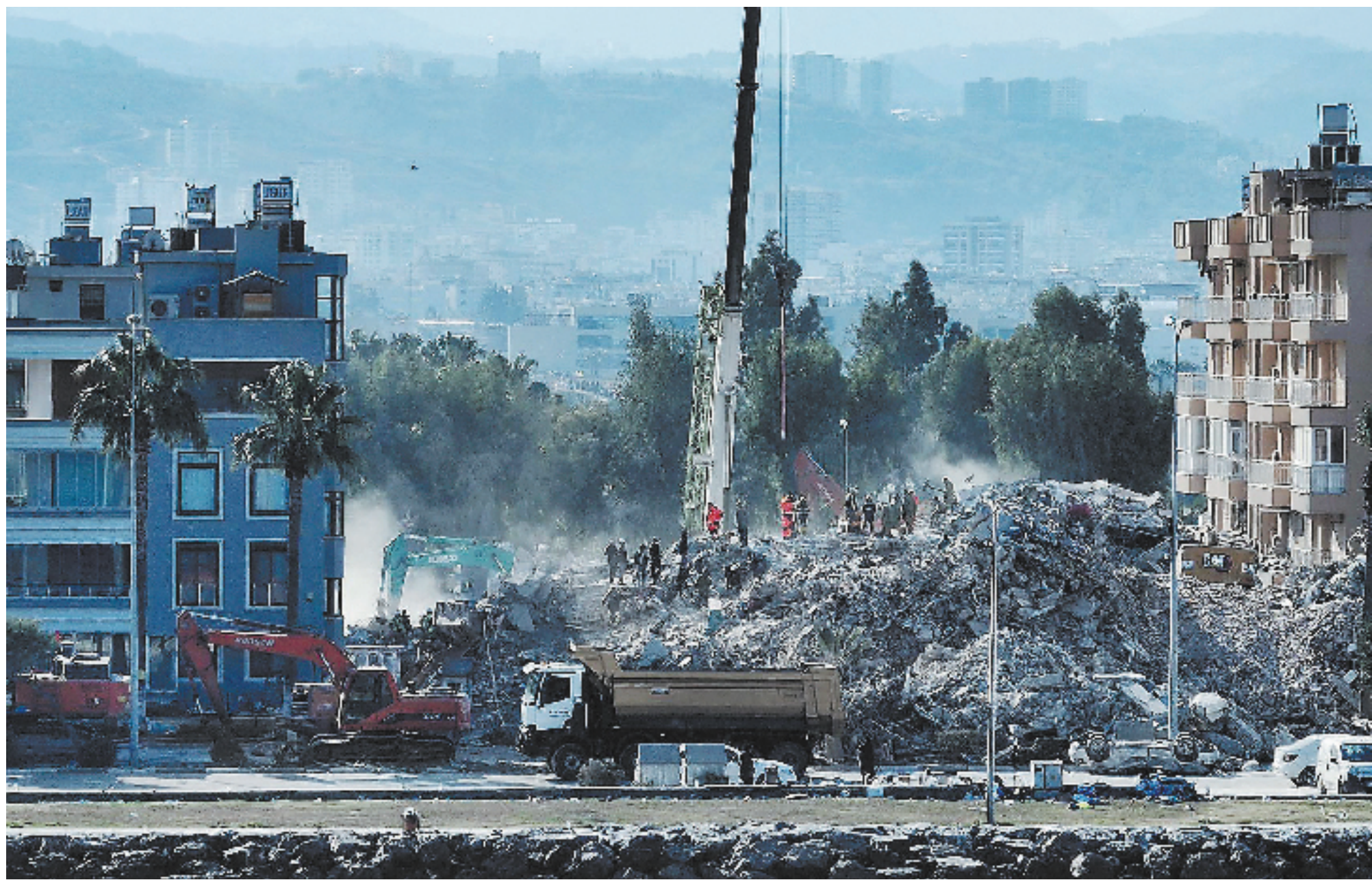
当地时间2月11日,土耳其伊斯肯德伦一处坍塌房屋的废墟上,救援队正在用吊机施救。
