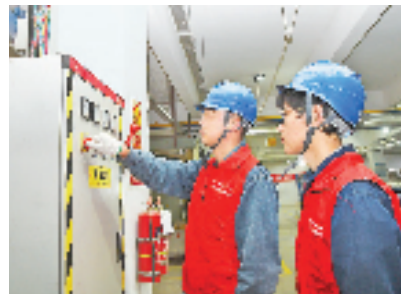
国网嵊州市供电公司员工仔细检查企业用电线路和设备运行状态,并向企业负责人询问用电需求。(图片由国网嵊州市供电公司提供)
