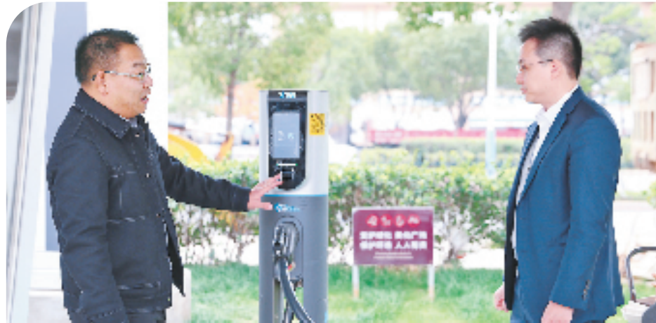
华夏银行台州玉环支行负责人在台州玉环商展中心调研，图为已投入使用的新能源汽车光储充电设备。
