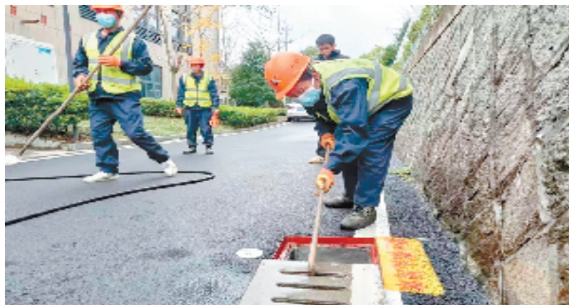
污水治理（图片由富阳区万市镇城建提供）
