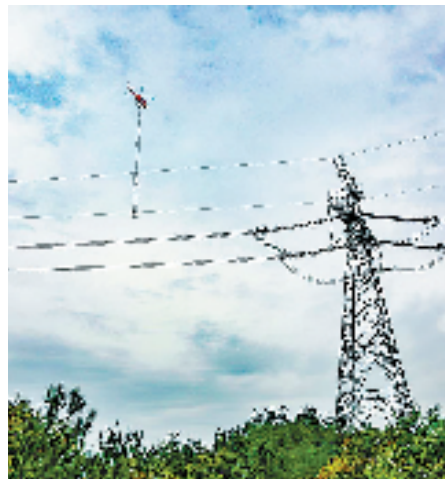
11月25日,国网衢州供电公司工作人员在超1000米的特高压线路山区复杂环境大跨越档开展直升机吊篮法带电作业 吴文涛 摄
