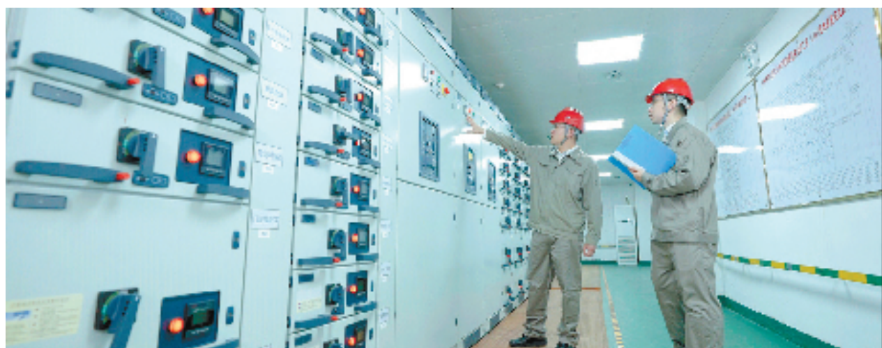
台州电力工作人员在空调系统机房调试设备 (图片由台州供电提供)
