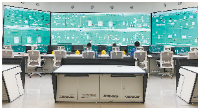
君业药业智能工厂监控室
