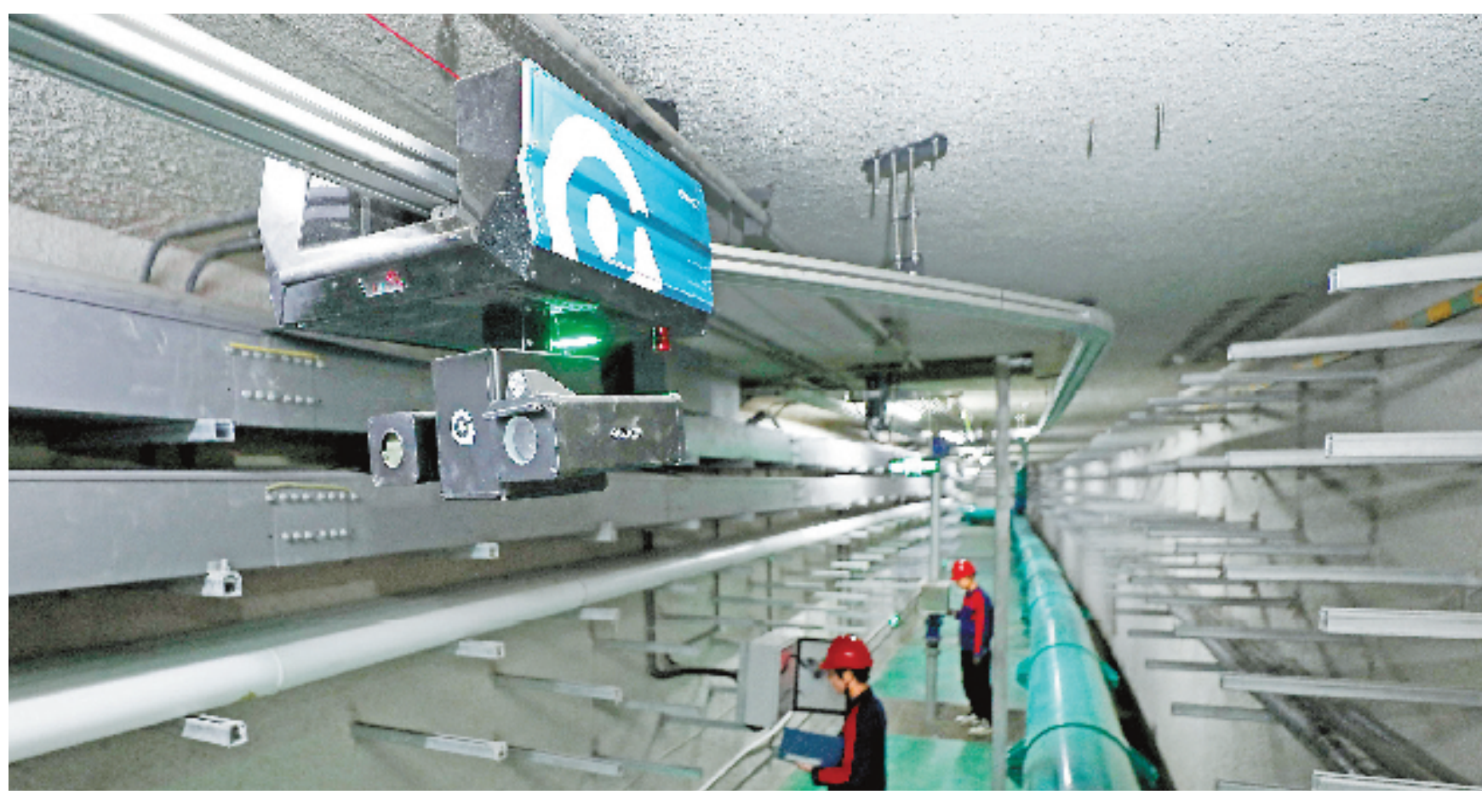
近日,杭州钱江世纪城亚运村片区地下综合管廊投用。该管廊全长21.5公里,是全国新建区域配置成网最完善的地下综合管廊系统之一。图为11月22日,智能巡检机器人在综合管廊巡检。
