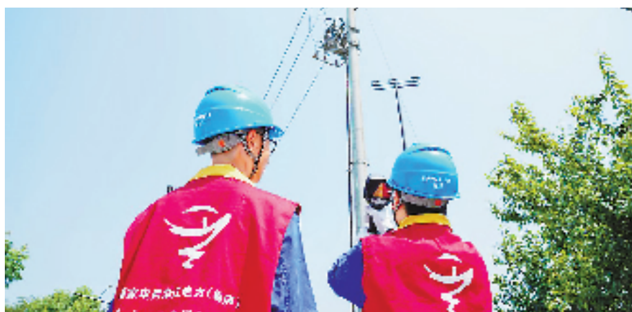
国家电网浙江电力(桐庐)红船共产党员服务队对吉利项目电力外线进行定期巡视测温等工作,确保用户用电无忧。 奚琪城 摄
