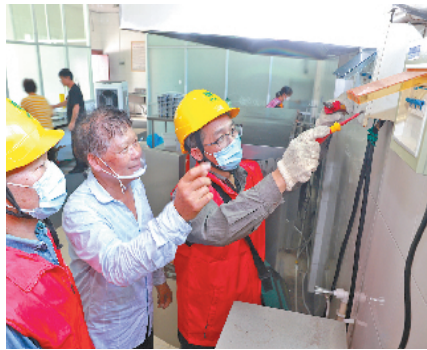
10月22日,红船服务队的党员祝其新和任炉军发挥自身技能专长,对“爱心食堂”后厨、餐厅的电气设备、用电设施等进行检查,消除安全隐患。王利刚 摄
