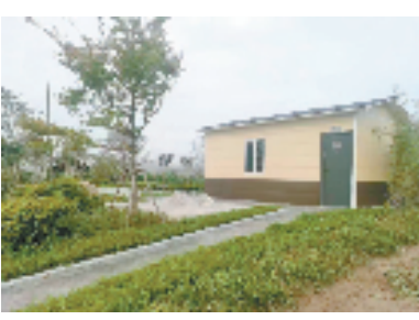
顺帆村农村污水处理终端(萧山区宁围街道供图)
