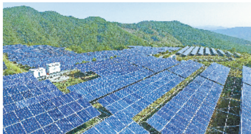
淳安县威坪镇叶家村明禹光伏电站投产，助力淳安绿色转型发展。
