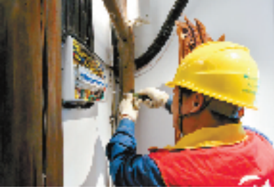
国网杭州市临平区供电公司员工正在塘栖古镇景区内开展安全用电巡检(谢枫 摄)
