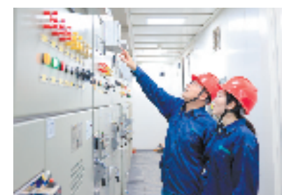
国网绍兴供电公司工作人员正在110千伏移动预装式变电站内检查设备 严璐瑶 摄
