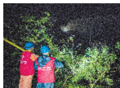
国网临海市供电公司员工在山间查找线路故障点 蒋宜秀 摄
