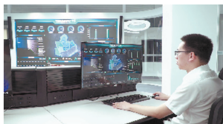
电力负荷管理中心利用“虚拟电厂”进行负荷监测 张蜜蜜 摄
