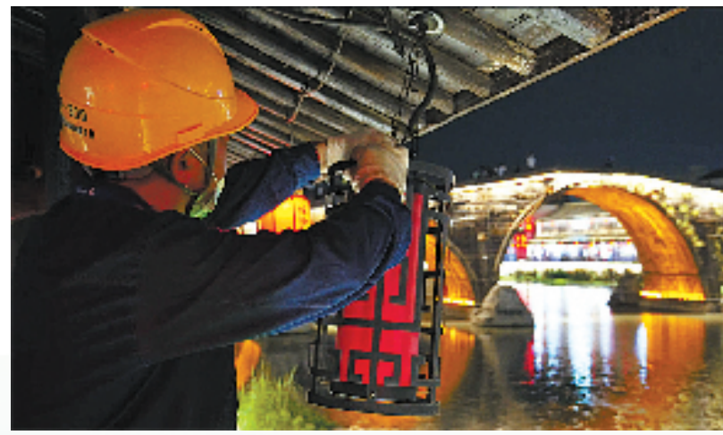
国网杭州市临平区供电公司员工正在检查电线线路接口 (图片由国网杭州市临平区供电公司提供)
