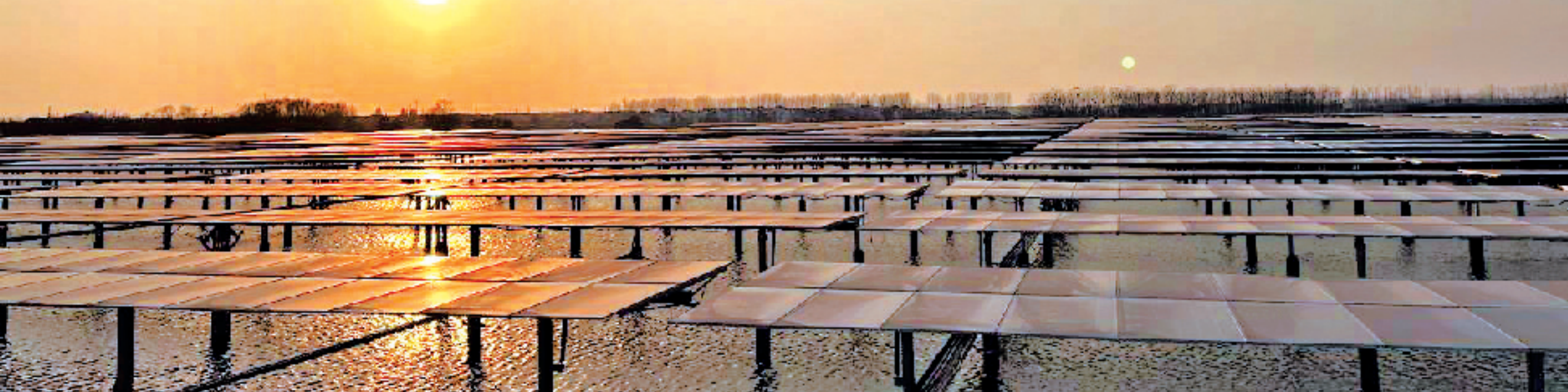
江苏丹阳市延陵镇80兆瓦渔光互补光伏发电项目,是浙能集团首个“跟踪式平单轴”光伏发电项目。拍友 林昌夏 摄
