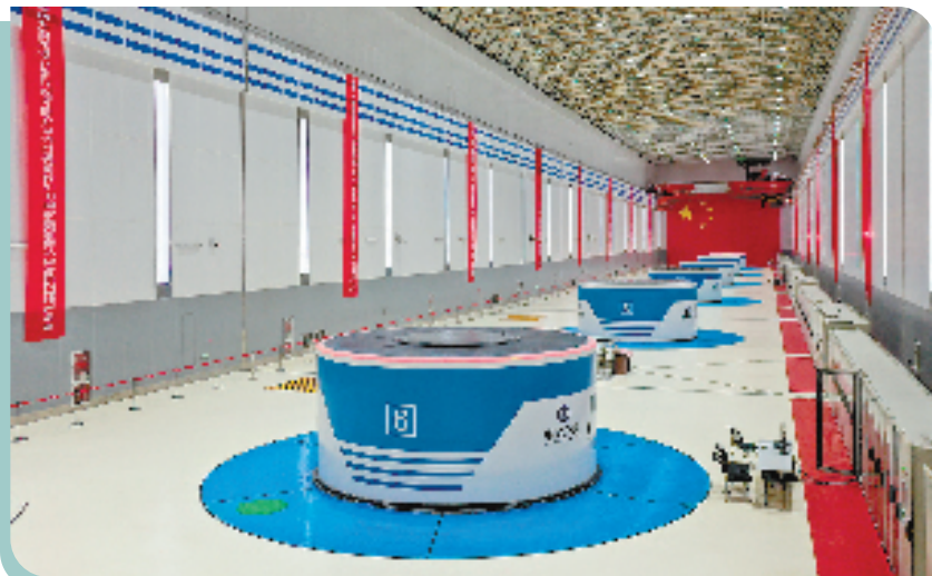
长龙山抽水蓄能电站全部机组投产发电 张卉 摄
