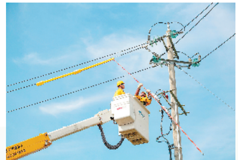
青年员工开展现场实训 (图片由安吉县供电公司提供)
