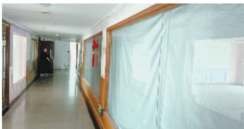
东清大厦E座部分楼层,疏散通道两侧的墙体均采用普通玻璃门进行分隔。
