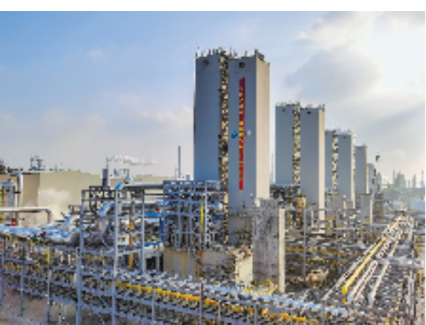
杭氧浙石化二期空分设备
