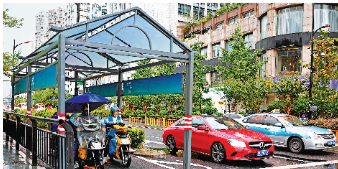
7月19日,在杭州中山北路朝晖路口,非机动车道上的遮阳棚安装好了。
