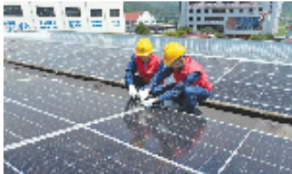
浙江星鹏铜材屋顶光伏项目
