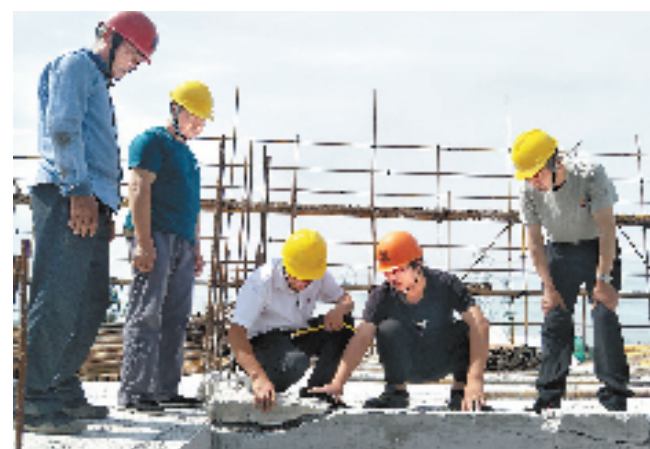
秀洲区王店镇庆丰村监察工作联络站工作人员对村部办公大楼施工情况开展例行监督 许莉冰 摄
