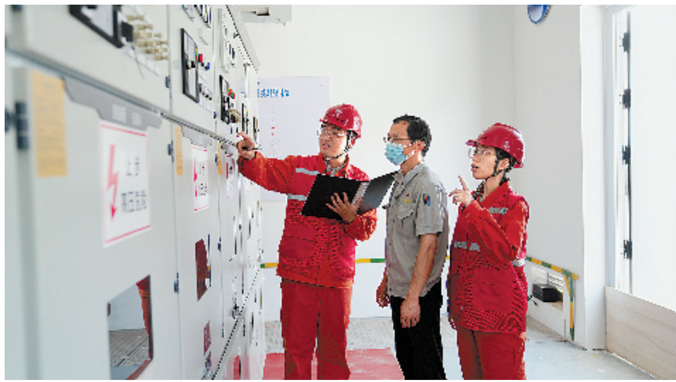
国网衢州供电公司工作人员了解企业生产用电情况和用电需求，并指导企业根据生产流程和用电实际，改善用电方案，降低电费开支。
