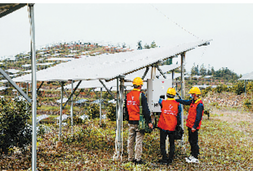
国网开化县供电公司员工来到易事特光伏电站，为配电房的电气设备及光伏电站进行安全巡检，保障光伏发电设备安全稳定运行。
