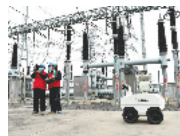
机器人开展电网变电设备智能巡检(图片由国网嘉兴供电公司提供)
