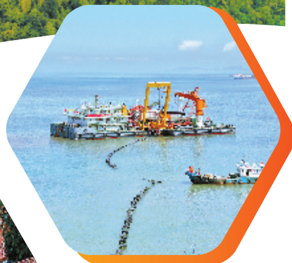
全球首条35千伏低频海底电缆在大陈岛入海,促进海洋清洁能源开发利用。
