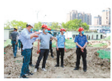
德清多部门组成联合检查组,对2个建筑工地开展建筑工地领域“综合查一次”。 (图片由德清县综合执法局提供)
