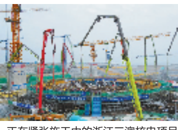
正在紧张施工中的浙江三澳核电项目(图片由温州农行办公室提供)
