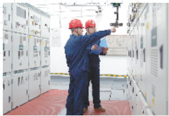
大有集团工作人员在杭州亚运会萧山体育馆通过中新巡检机器人进行消缺检查工作
