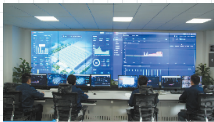
大有集团欣美智慧工厂“光充储”一体化绿色低碳平台
