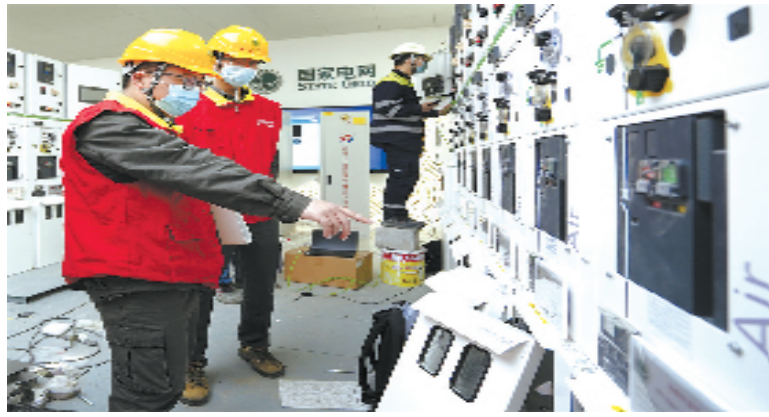
3月14日,工作人员对德清县地理信息小镇亚运会三人制篮球馆电力开关站内设备进行通电前验收,确保供电安全可靠。 陈海龙 摄
